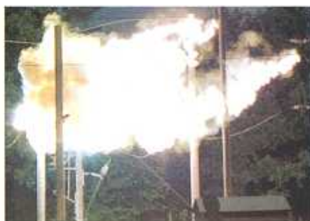
Eine falsch ausgeführte Erdung hält den Kurzschlussstrom von 6.5 kA nicht aus und verdampft. Dies hat einen Lichtbogen zur Folge, der sich von der Anspiesung weg der Leitung entlang bewegt.
